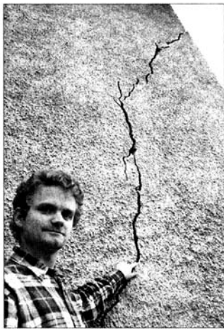
Philipp Günzel zeigt auf Risse als Folge der Wasserausbeutung. Foto: uri
